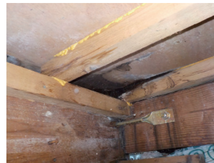
バルコニー排水口部 保護モルタル下 防水の劣化による雨漏り
