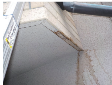
バルコニー排水口雨漏り ベニヤ赤水あくの発生
