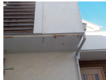
バルコニー排水口雨漏り ベニヤ赤水あくの発生
